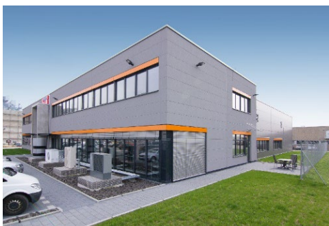
Foto 01: Wärmepumpen in Außenanlage, Foto: TWK Test- und Weiterbildungszentrum Wärmepumpen und Kältetechnik GmbH/Niki Hüttner
